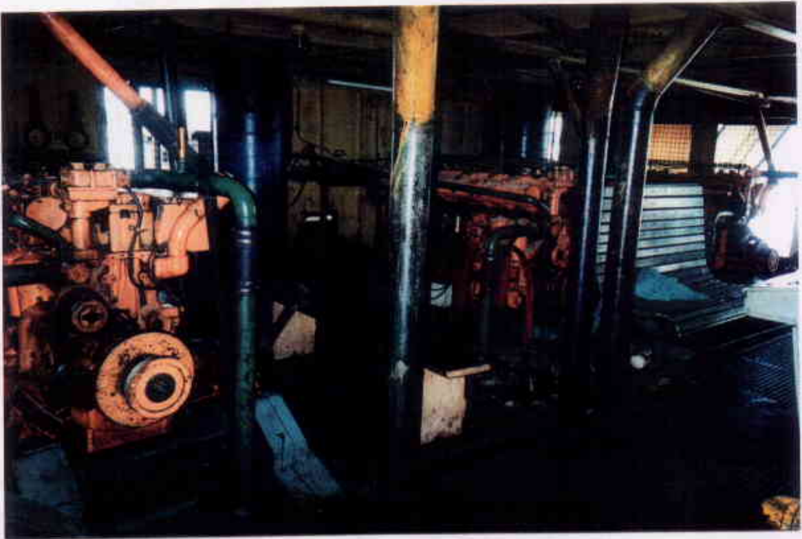
SALLE DES MACHINES
